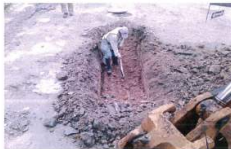
EXCAVACION A MANO PARA ZANJAS EN MATERIAL COMUN EN SECO HASTA 4.00 M. DE PROFUNDIDAD
