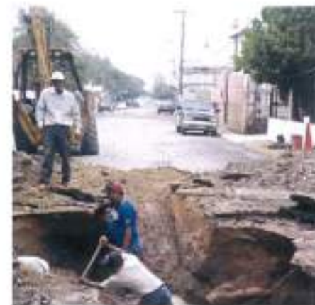
EXCAVACION A MANO PARA ZANJAS EN MATERIAL COMUN EN SECO HASTA 4.00 M. DE PROFUNDIDAD.
